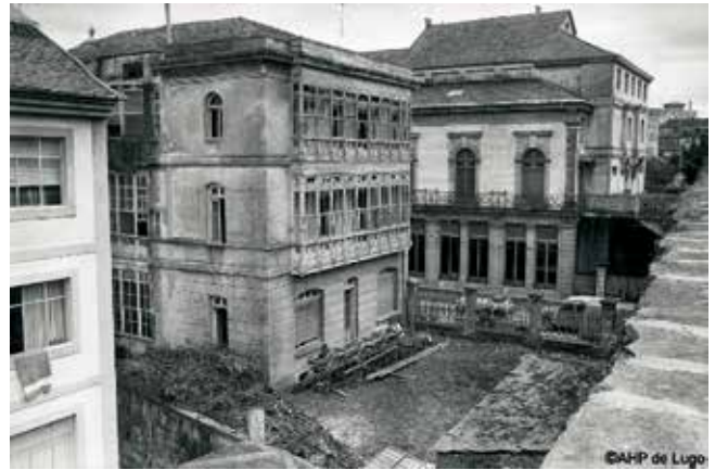
Fig. 24. La casa del Sr. Magadán, alterada arquitectónicamente. En proceso de derribo en los años 70. AHPLu. Foto Vega, sig. 11.901-16, carpeta 120, abril-junio de 1978.
