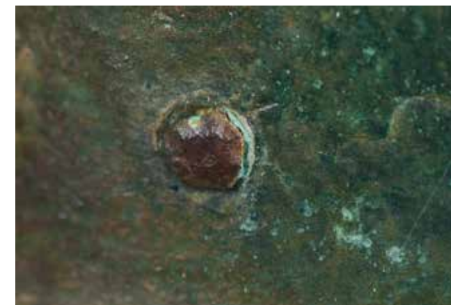
Fig. 9. Detalle da posible corrosión no remache de ferro.
