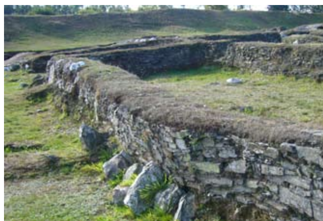
Imaxe 6: Abombamento do muro.
